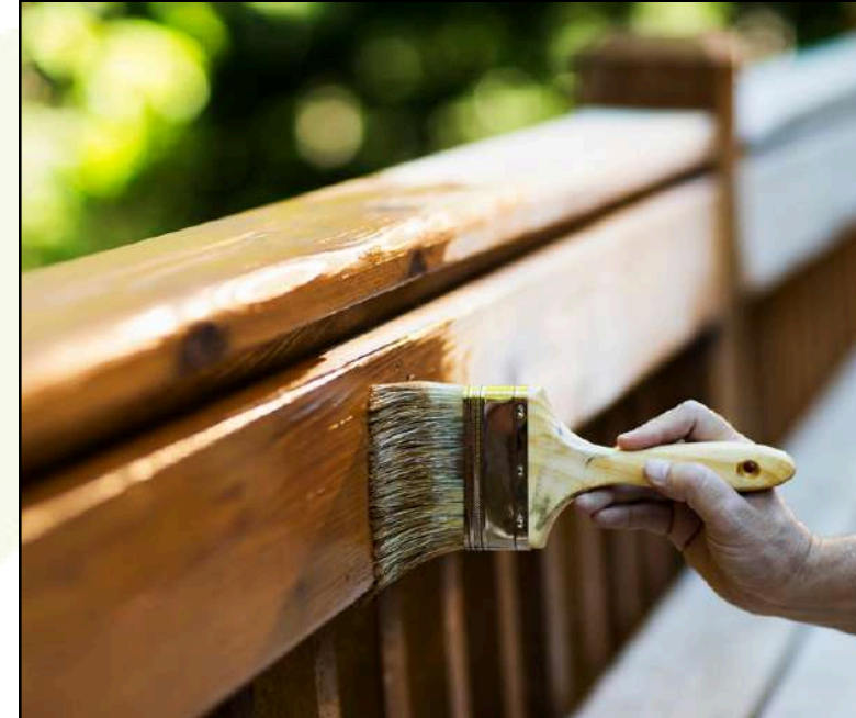
Revêtement sur boiseries en peinture glycérophthalique ( finition B*)
