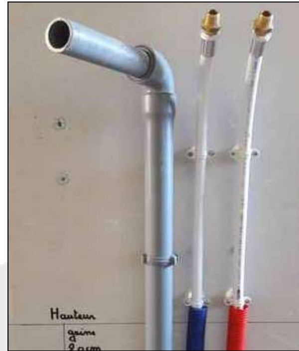
Attente d'eau chaude et froide avec évacuation
